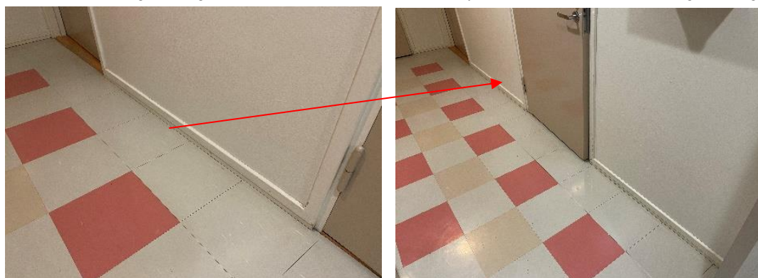
Bild 3. Markering 2. Mögelhunden markerade konstruktionsfogen vid golvet på en mellanvägg mitt emot utrymme 122 i korridor 112_5. Mellanväggen (ingen konstruktionsgenomskärningsbild tillgänglig) är enligt uppgifter från disponenten en bärande konstruktion och grundad under golvytan.
