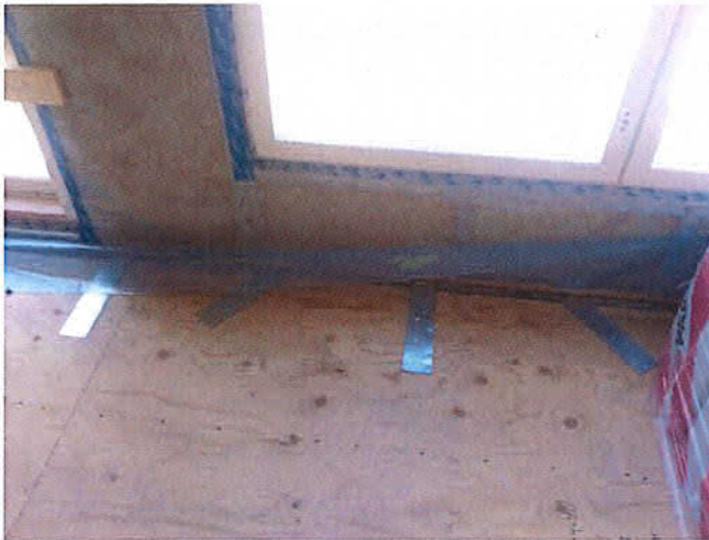
Kuva 4. Höyrynsulun ehjyys välipohjien kohdalla on haasteellista ulkoseinäelementtien kiinnikkeiden vuoksi. Höyrynsulku on otettava huomioon sekä rakenteiden liitosten suunnittelussa, että työjärjestyksiä suunniteltaessa.
