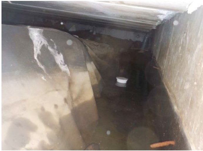
Irtovesi ryömintätilan kuopassa
