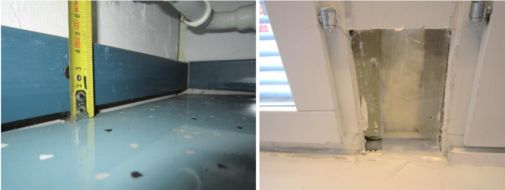
Kuva 4. Esimerkkejä 1990- luvulla rakennettujen rakennusten ilmatiivyspuutteista. (kuvat Vahanen Rakennusfysiikka Oy:n arkisto)
