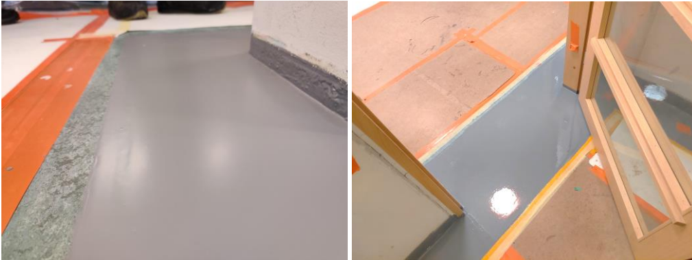
Kuva 7. Esimerkki pintarakenteiden päälle tehdyistä tiivistyksistä: korjaustaso C, tiiviydeltä tavoiteltava laatutaso 2, käyttöikätaivoite 5 vuotta. (kuvat Vahanen Rakennusfysiikka Oy:n arkisto)
