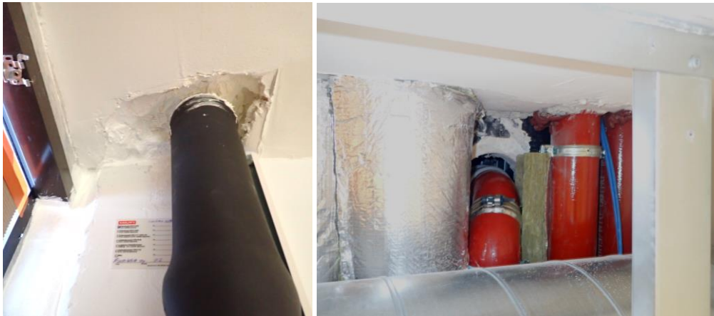
Kuva 8. Esimerkki korjaustasosta C, palokatkotiiivistyksiset. Tiiviyden tavoitetaso 3, käyttöikätaivoite 20 vuotta. (kuvat Vahanen Rakennusfysiikka Oy:n arkisto)
