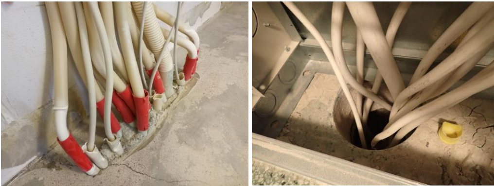
Kuva 5. Esimerkkejä läpivientien ilmatiivyspuutteista. (kuvat Vahanen Rakennusfysiikka Oy:n arkisto)
