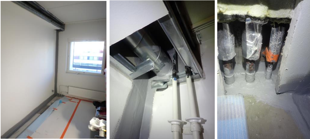
Kuva 2. Kohde, jossa rakenteita on tiivistetty ulkoilmasta kulkeutuvan tupakansavun sekä ääneneristyspuutteiden vuoksi. (kuvat Vahanen Rakennusfysiikka Oy:n arkisto)
