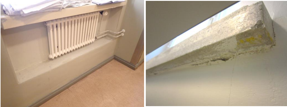
Kuva 3. Esimerkkejä 1920-luvulla valmistuneiden rakennuksen liitoskohtien ilmatiiviyyspuutteista. (kuvat Vahanen Rakennusfysiikka Oy:n arkisto)
