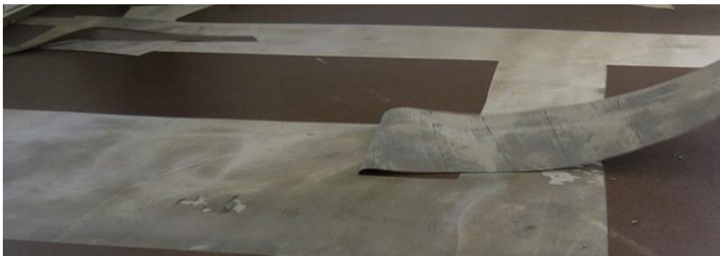
Kuva 18. Muovimattoa on avattu paikoitellen. Paikallisesti vaurioitunut alue näkyy kuvassa etualalla tummempänä. Matto oli näiltä osin heikosti kiinni alustassa ja haju maton alla oli huomattavasti voimakkaampi kuin kuvan ylälaudassa olevassa hyväkuntoisessa avauskohdassa, jossa pinta oli vaalempi ja matto tiukemmin kiinni alustassa. (Kuva: Vahanen Rakennusfysiikka Oy)
