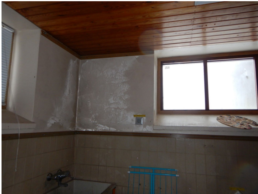
Ulkoseinän kylmäsilta rakenne.
