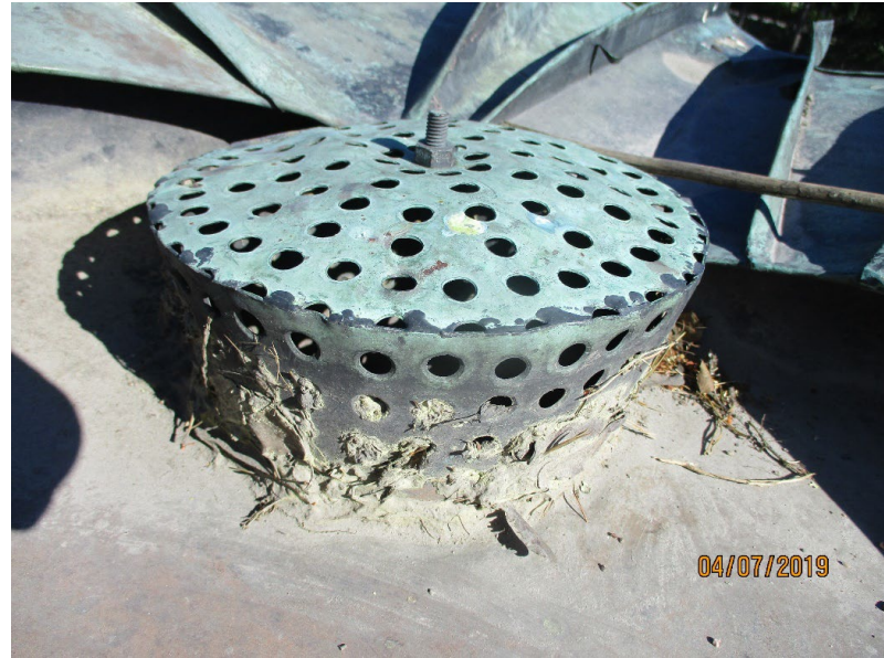
Kuva 2. Kattokaivo tukossa huollon laiminlyönnin johdosta. Padottaa sadevesiä katolle
