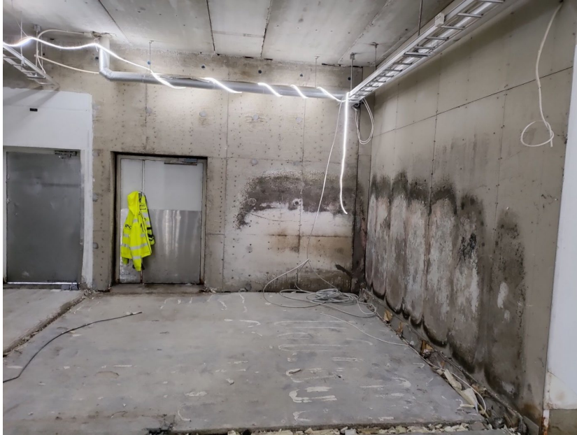
Kylmiön seinät levyjen poiston jälkeen, kondenssi
