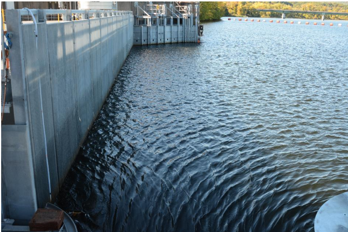
Kuva 8. Tiheä välppärakenne, jolla alasvaeltavat kalat pyritään ohjaamaan voimalaitoksen turbiinit kiertävälle reitille. Kuva: Panu Orell.
