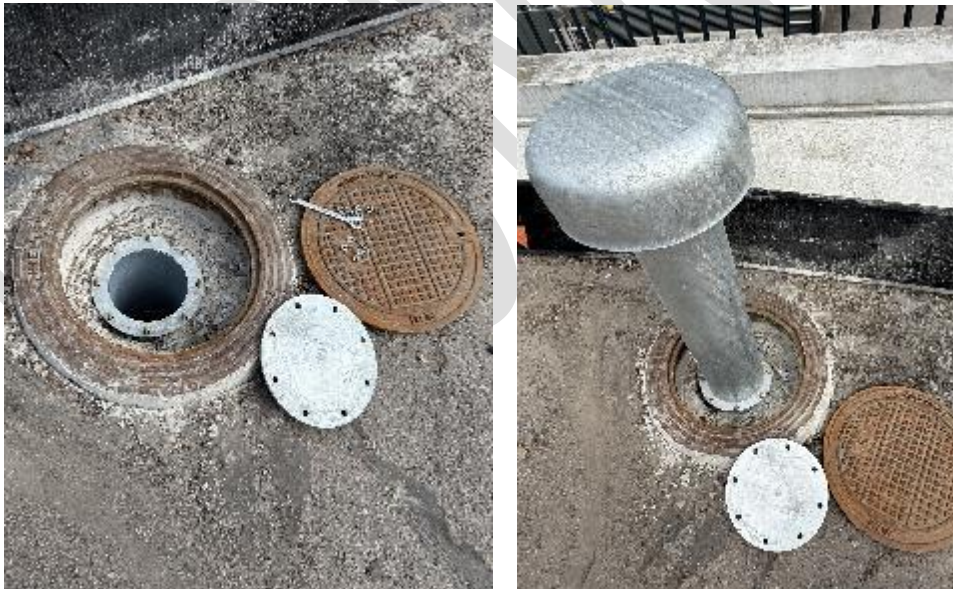
Kuva Vasemmalla kuvassa ilmanottoputkelle tehty kaivo, joka voidaan peittää kannella. Oikealla kuvassa ilmanottoputki kiinnitettynä tiiveyskokeen ja käytön aikana. (Kuvat: Martin Mitikka)
