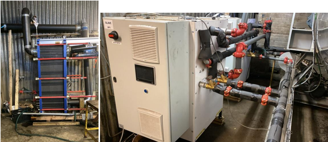
Kuva 1. Lämmöntalteenoton yksiköt eli pumput ja lauhdutin.
