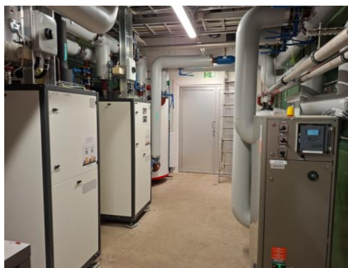
KUVA 1 LÄMPÖPUMPUT, ENERGIAVARA AJA JA SÄHKÖKATTILA MUOKATUSSA TEKNISSÄ TILASSA
