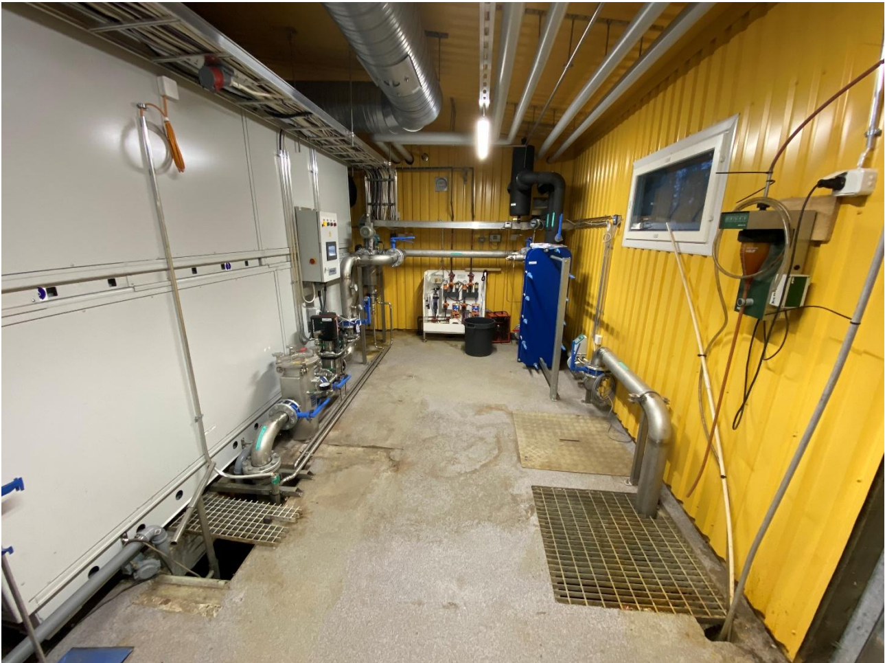
Vasemmalla ilmanvaihdon LTO-kone, jonka vieressä jätevesilämpöpumpun syöttöpumppu ja suodattimet. Sininen laite seinän vieressä on jätevesilämpöpumpun lämmönvaihdin.
