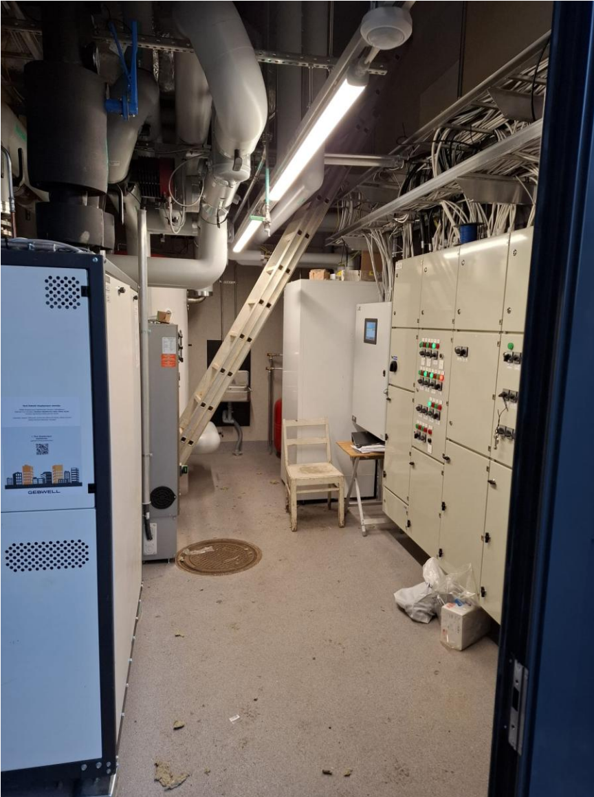
Jätevesilämpöpumpputila, vasemmalla edessä jätevesilämpöpumppu
