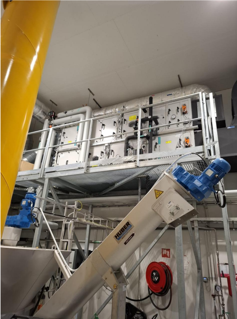
Esikäsittelyrakennus, ilmanvaihdon LTO-laite
