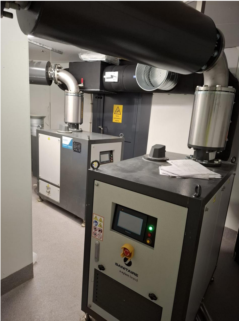
Uusi ilmastuskompressori (etualalla)
