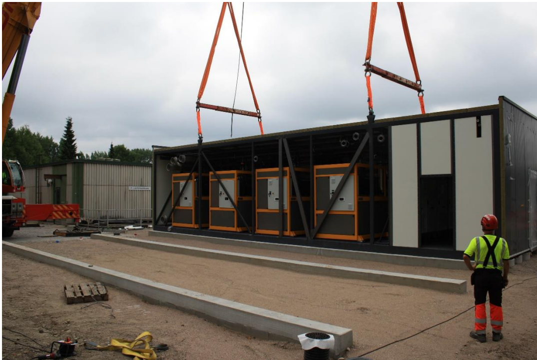
Kuva 2. Uusi lämpöpumppulaitos saapui Lahteen. Lämpöpumppulaitos koostuu kolmesta moduulista.
