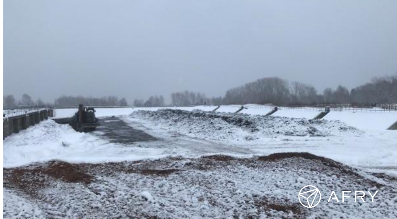
Tunturi-Lapin Vesi Oy: eristetty lietekontti
