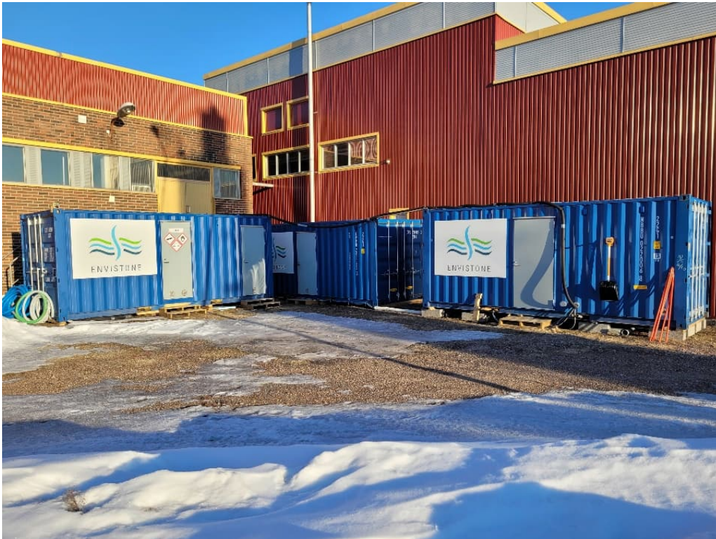
Kuva 4. MobiN laitteisto Riihimäen jätevedenpuhdistamolla
