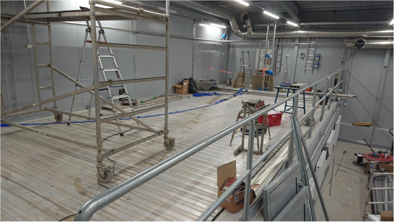
Kuva 8 Lamelliselkeyttimet ovat alumiinilankkujen alla omassa betonialtaassa.
