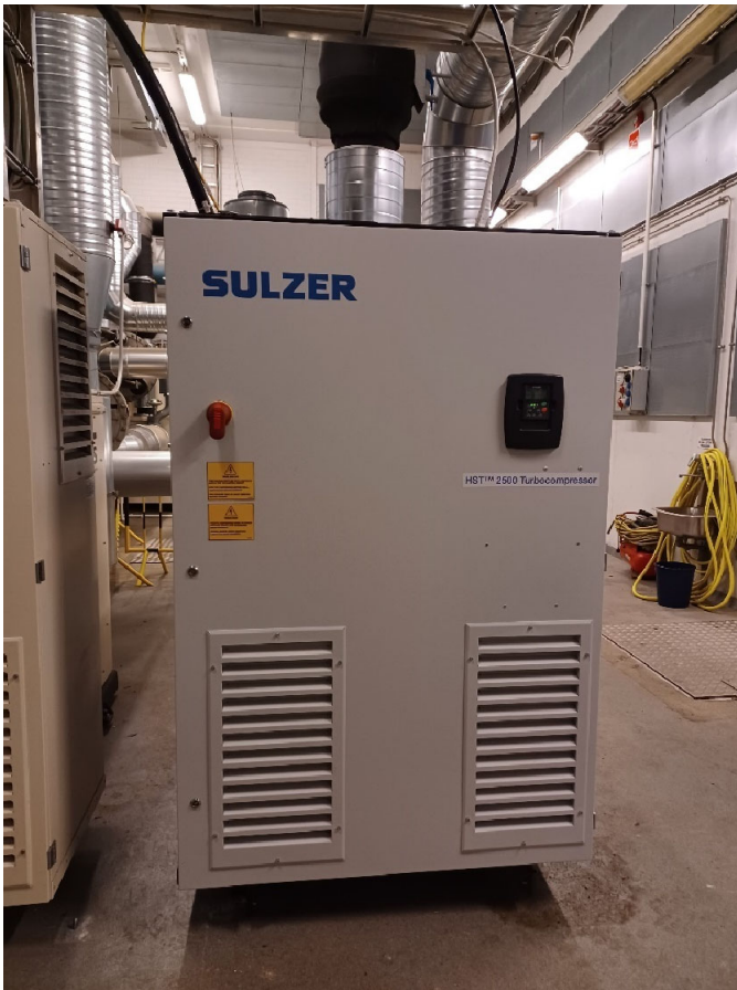
Kuva 3. HST 2500-2-H-4 ilmastuskompressori asennettuna ja valmiina käyttöön.
