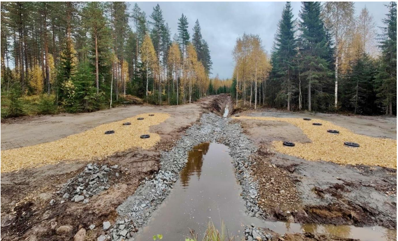
Kuva 6. SuVaKi- hankkeessa tutkittiin puuhakebioreaktorirakenteiden soveltuvuutta suometsävesien käsittelyyn. Kirsi Karhio / Pro Höytiäinen ry
