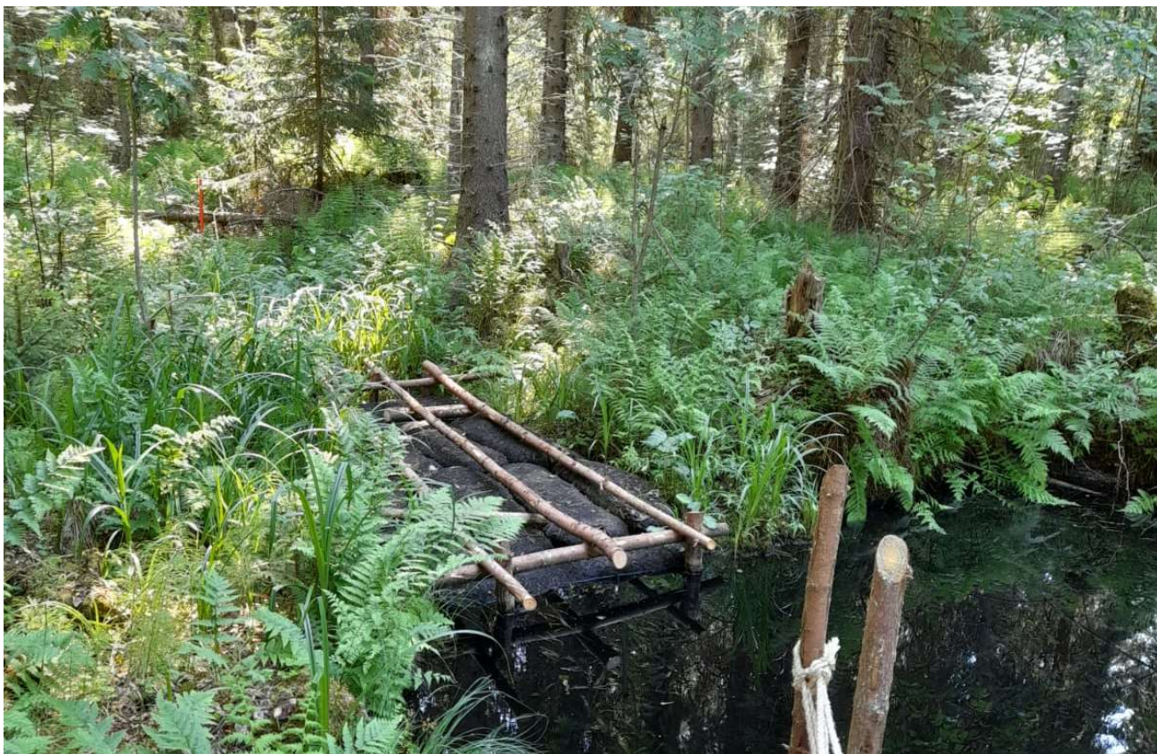
Kuva 8. Puuhake-biohiilisuodatinsäkit altaan lähtöuomaan asennettuna ensimmäisenä vuonna kesäkuussa 2023.
