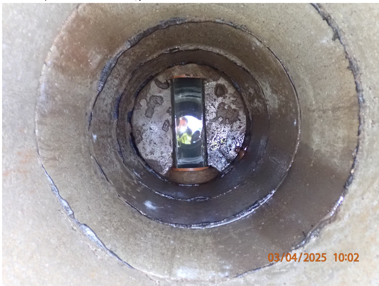
Kuva 5. Sampolan alueella oleva kaivo, jonka saumat vuotavat
