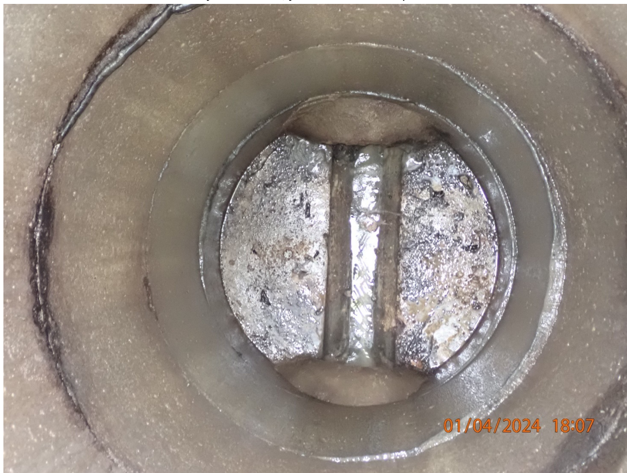
Kuva 3. Laidunmaan alueella oleva jätevesikaivo, jonka molemmat läpiviennit vuotavat
