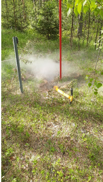
Kuva 3. Merkkisavua vapautuu viettoviemäristä aukinaisen kaivonkannen kautta.
