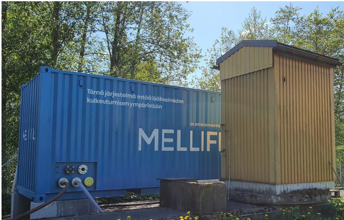
Figur 6. Ansluten pilotanläggning i container på plats vid Pitkäniemi avloppsreningsverk.
