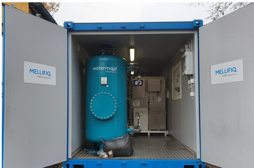
Figur 9. Öppnad container med synlig GAK-filtertank och rostfritt ozonsystem.
