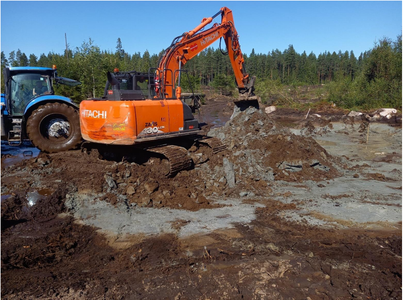
Kuva 14. Kaivamalla perustettavan kosteikonosan rakennustyötä Koveskoskisen tilalla 14.08.2024. Kaivumaat ajettiin pääosin alapuolisen patopenkereen rakennemassoiksi.
