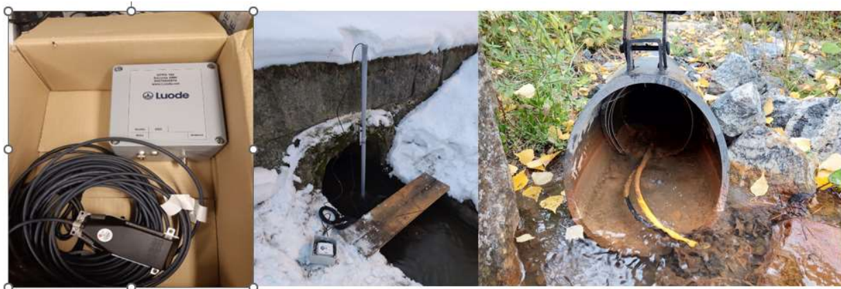
Kuva 12. Vasemmalla virtausmittari sekä loggeri. Keskellä ja oikealla kaksi erilaista virtausmittaria asennettuna.
