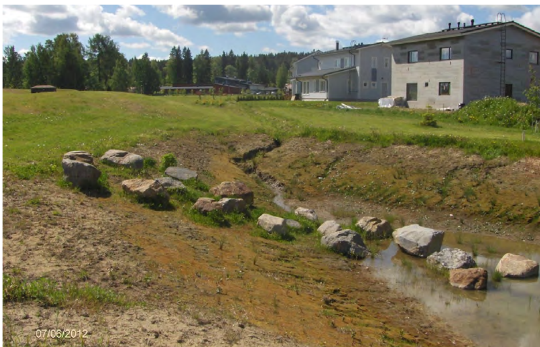
Kuva 5. Sadekuuron aiheuttama eroosio on huuhtonut luiskaan levitetyn kasvualustan siemenineen hulevesien imeytys- ja viivytyspainanteen pohjalle. Valokuva Ramboll / Päivi Paavilainen 2012
