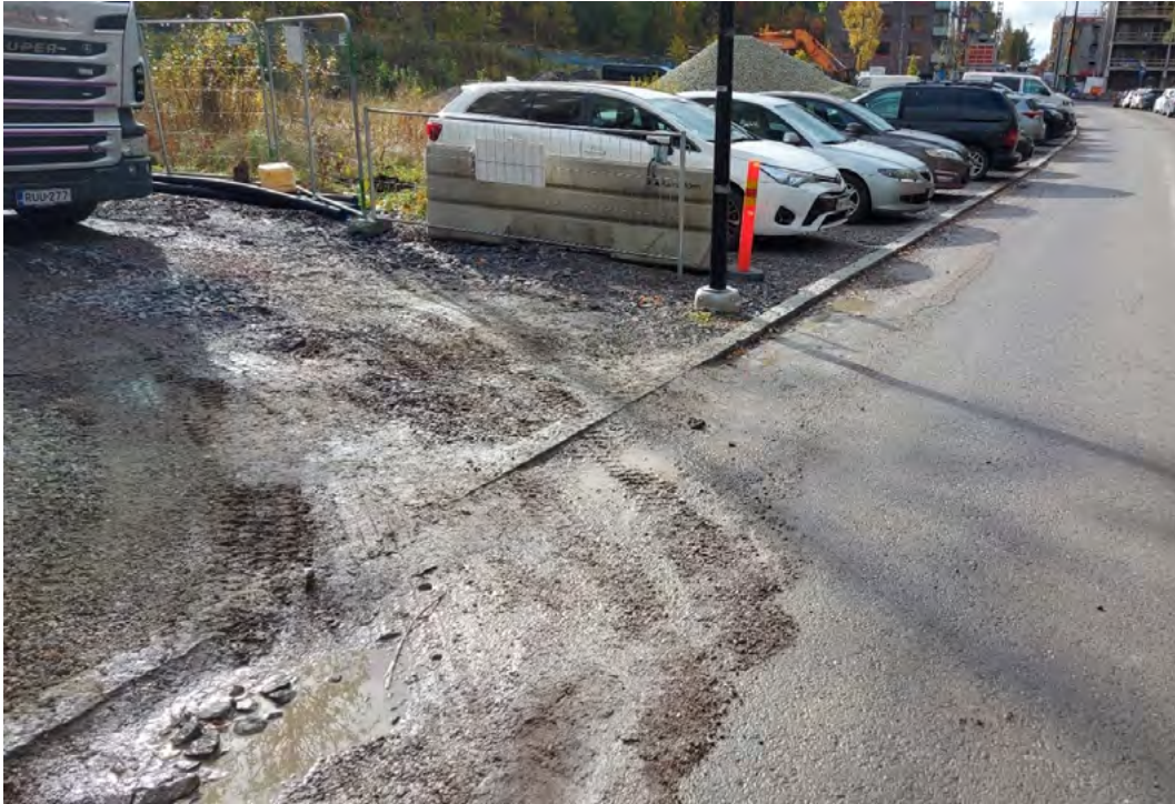
Kuva 2. Myös työmaaliikenne aiheuttaa kiintoaineskuormitusta levittämällä maa-ainesta päällystetyille kaduille, joista se huuhtoutuu hulevesiviemäriin. Työmaaliikenteen aiheuttamaa kuormitusta on mahdollista vähentää antamalla veloitteita työmaaliittymien rakentamisesta karkeasta materiaalista ja katujen säännöllisestä puhdistamisesta kiintoaineksen keräävällä kalustolla. Menetelmiä on kuvattu tarkemmin luvussa 4.5.1. Valokuva Ramboll / Päivi Paavilainen 2022.
