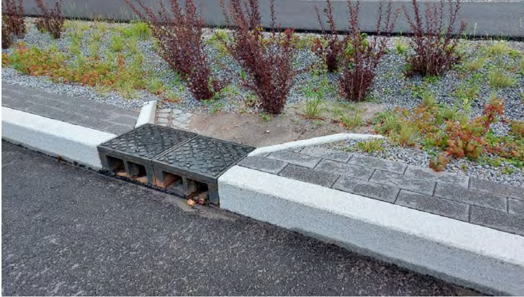
Kuva 9. Hulevedet on mahdollista ohjata viherkaistalle ilman katkoa reunakivilinjassa, kun käytetään tarkoitukseen suunniteltua kitakaivoa. Valokuva Ramboll / Päivi Paavilainen 2022.
