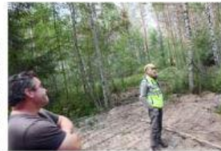
Jari Mussaari täytti vanhan ojan maa-aineksilla. Jarkko Leka arvelee, että vuoden päästä kaivuun jälkiä ei juuri näy.
