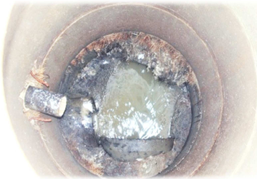
Kuva 9: Mittauksien aikana löytyi kaivo, jonka kiinteistön viemäriputken läpivienti oli jätetty paikkaamatta. Nyt läpiviennistä tulee vuotovesien lisäksi juurakkoa kaivoon.
