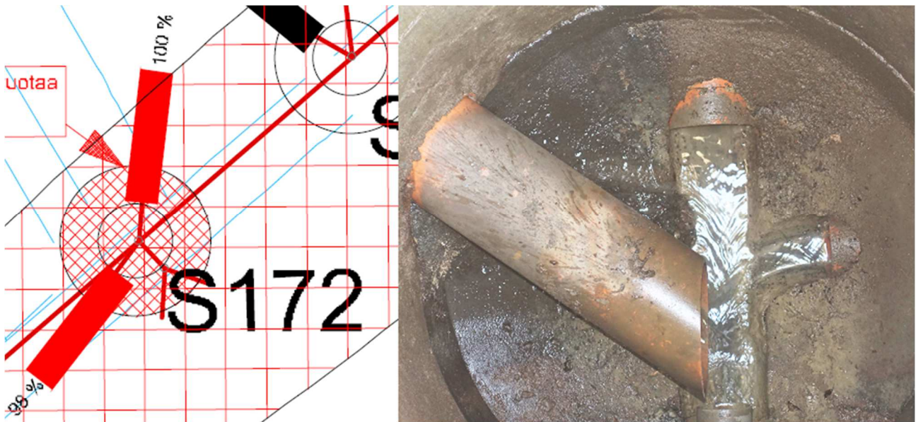
Kuva 2: Raportin mukaan kaivo s172 vuotaa, jonka myös kaivosta otettu kuva osoittaa.
