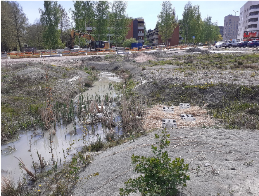
Kuva 1. Ruokosuodatin Fallkullan työmaalla, työmaa-alueen läpi kulkevan puron sivuhaarassa.
