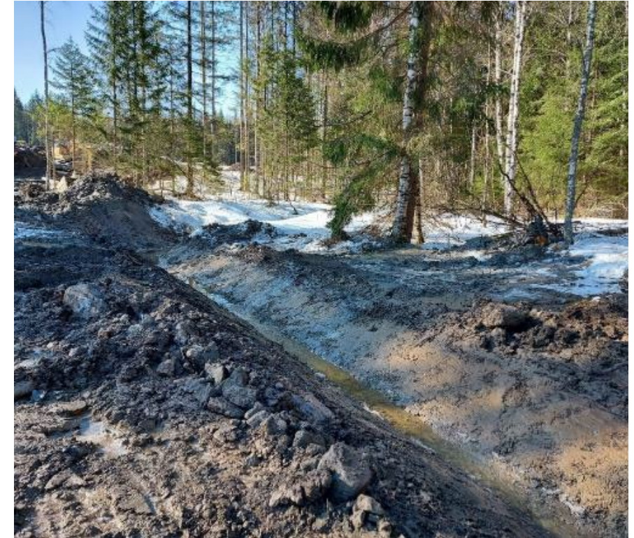
Kuva: Aluerakentamisen työmaa-alueita, jossa sulamisvedet pääsevät esteettä huuhtelemaan mukaansa maa-ainesta paljaalta maanpinnalta.
