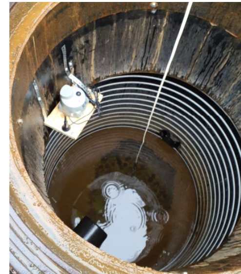
Pinnankorkeuden mittausanturi Puutarhakadun salaojakaivoon asennettuna.
