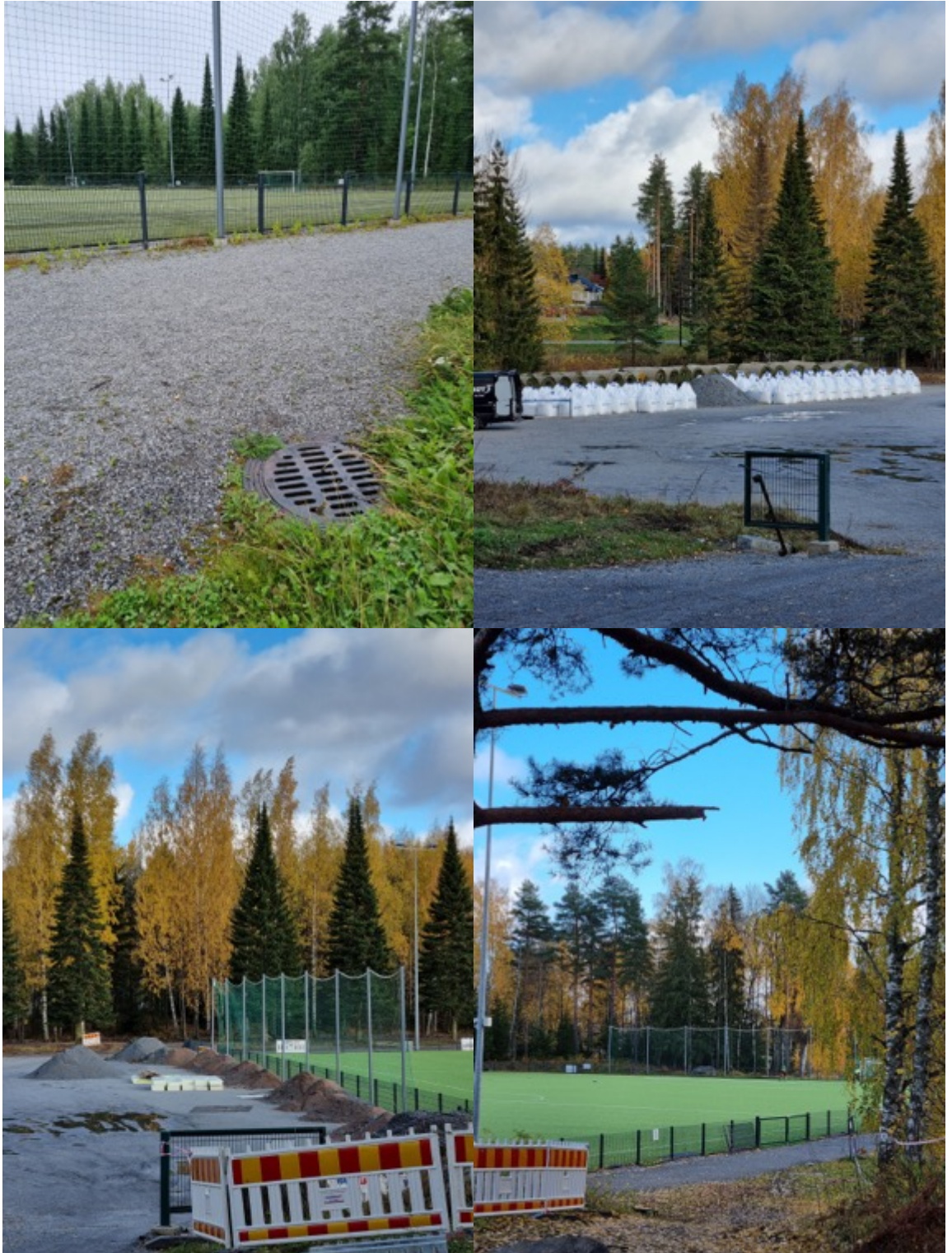
Kuva 8. Menkalan tekonurmikenttä Nokialla. Ylhäällä vasemmalla on kuva sadevesikäivosta, josta näytteet otettiin. Muut kuvat on otettu tekonurmikentän vaihtourakan aikana.
