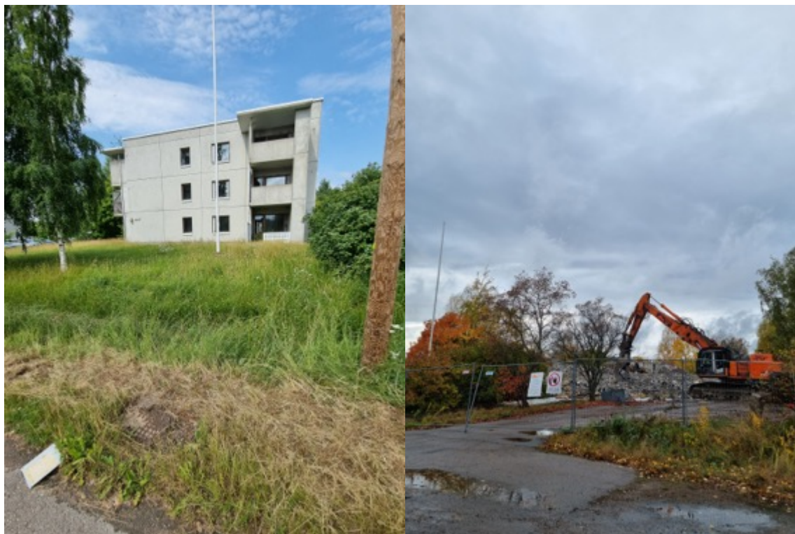
Kuva 6. Valokuvia kohteesta Ratatie 4, Kouvola. Vasemmalla on rakennus ennen purkua kesällä 2022 ja oikealla käynnissä on raskaspurku saman vuoden syksyllä.
