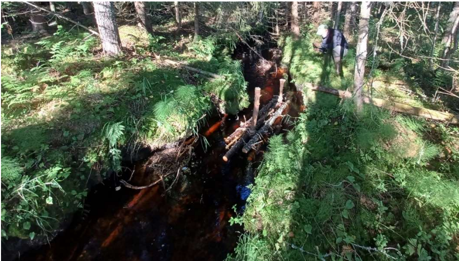
Kuva 7. Puupuhdistamo asennettuna Pahkapuroon Keuruulla yhteistyössä Metsä Group Finsilva Oyj:n kanssa 26.8.2022. Kuva: Riku Huuskola, KVVY Yhdistys
