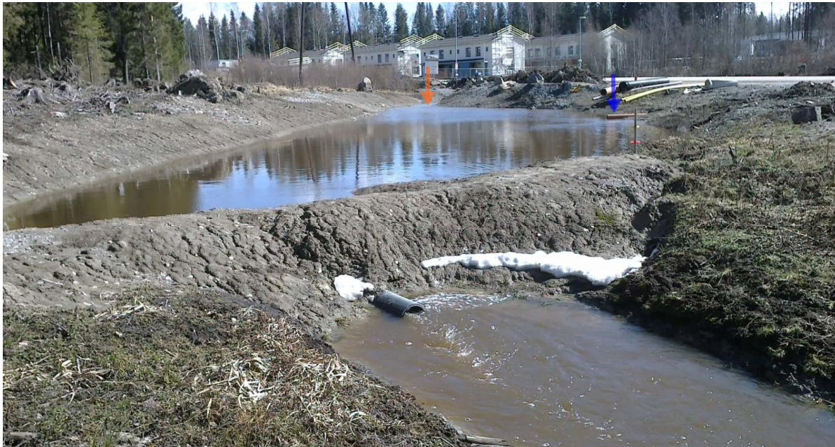
Kuva 7. Huonosti toimiva laskeutusallas. Kuvassa näkyy useampia ongelmakohtia: liikaisen käsiteltävän veden lisäksi (oranssi nuoli) altaalle on johdettu myös puhtaita vettä (sininen nuoli), mikä heikentää puhdistustulosta kasvattamalla virtaamaa tarpeettomasti. Lisäksi puhtaiden vesien virtaus on johdettu altaalle sen keskivaiheilla, mikä aiheuttaa turbulenssia ja huonontaa laskeutumisololoja. Ylikuormitus ja ylivuotoreitin puuttuminen näkyvät altaan purkupäässä, jossa hallitsemattomasti yli vuotaneet vedet ovat syövyttäneet patoon kuvan oikeassa reunassa näkyvän syvän roillon. Altaan suojaamattomat maa-luiskat ovat syöpyneet voimakkaasti ja mahdolliset kasvualustat ja siemenkylvöt ovat huuhtoutuneet veden mukana altaan pohjalle ja vastaanottaviin ojiin.
