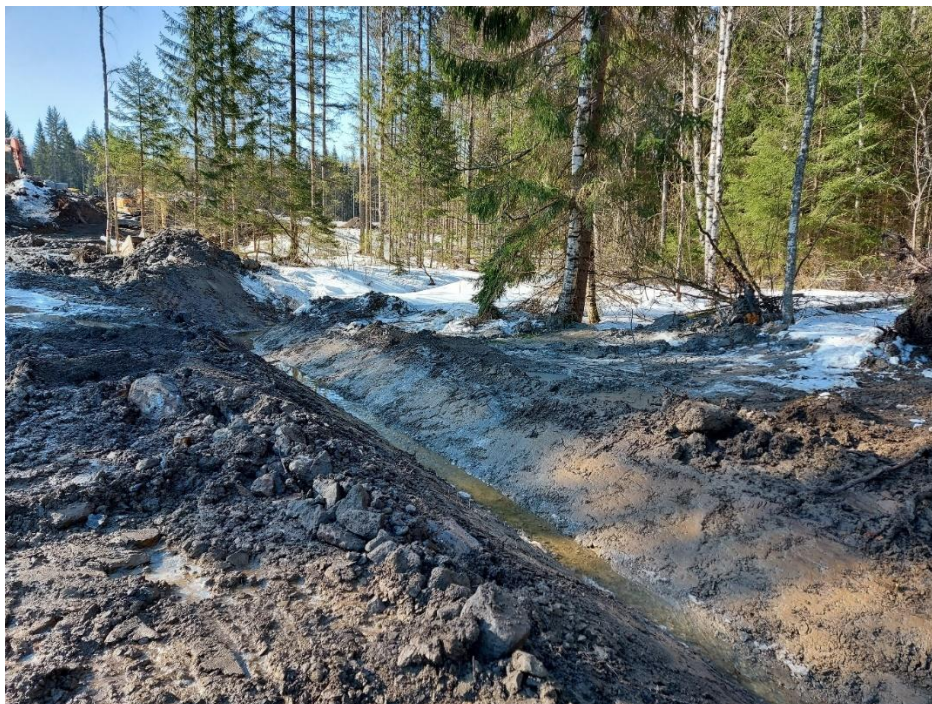
Kuva 2. Tyypillistä aluerakentamisen työmaa-aluetta, jossa sulamisvedet pääsevät esteettä huuhteamaan mukaansa maa-ainesta paljaalta ja löyhtyneeltä maanpinnalta.
