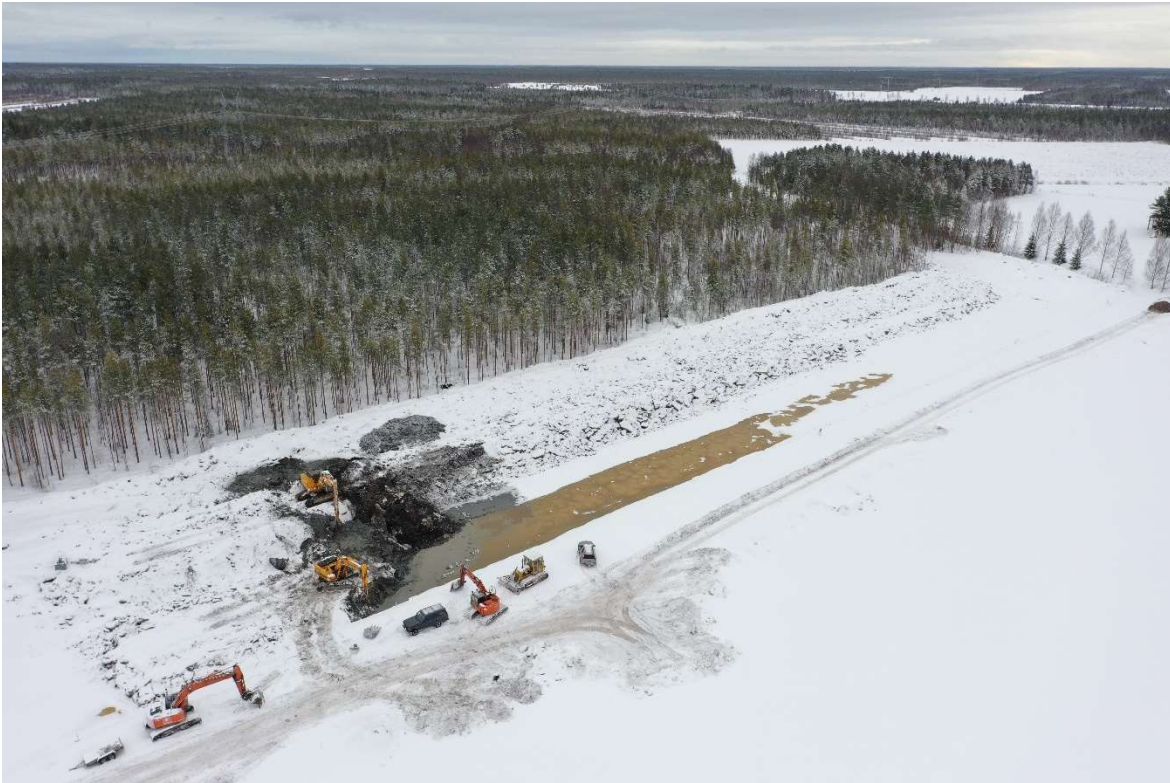
Kuva 5. Turvekerroksen alla oli savikerros, joka pyrittiin kaivamaan takaisin syvälle maahan, kun ylijäämämaat sijoitettiin altaan metsän puoleiseen penkkaan. Kuva: Jusa Kokko, Luke.
