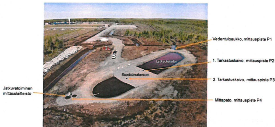
Kuva 1. Vesiensuojelurakenne ja vesinäytteiden ottopisteet. (Sirviö et al., 2020)
