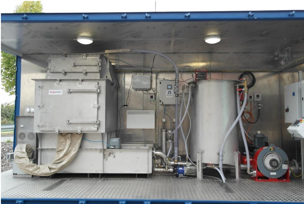
Kuva 2. PLÄTS-prosessi asennettuna kohteeseen.
