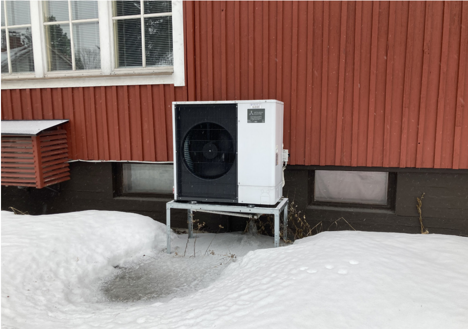
Kuva 1. Ilma-vesilämpöpumpun ulkoyksikkö omalla jalustalla Hyrylän torpalla. Kuva: Jukka Korri/Ramboll.
