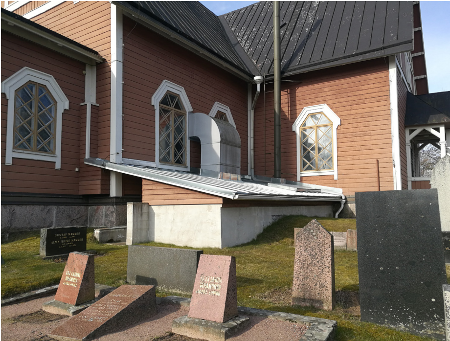
Kuva 22. Ilmalämmitysjärjestelmän kanava ennen maalämmön asennusta. Kuva: Jukka Hammaren/FinProma Oy.
