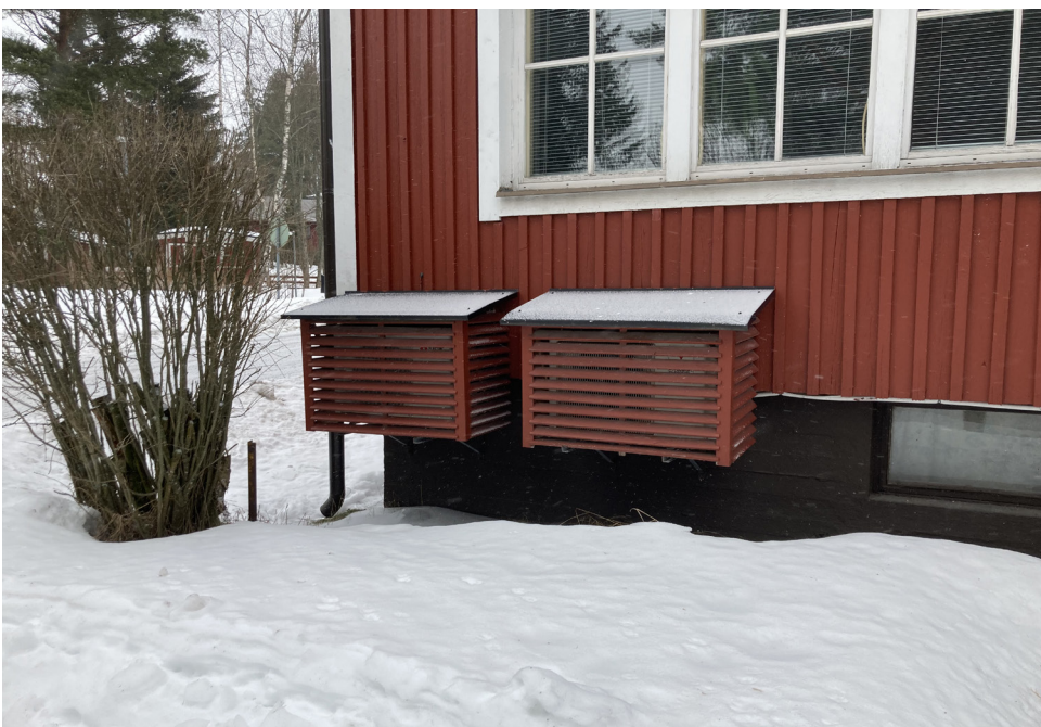
Kuva 2. Kaksi koteloitua ilma-ilmalämpöpumpun ulkoyksikköä kiinnitettynä ulkoseinään Hyrylän torpalla. Kuva: Jukka Korri/Ramboll.
