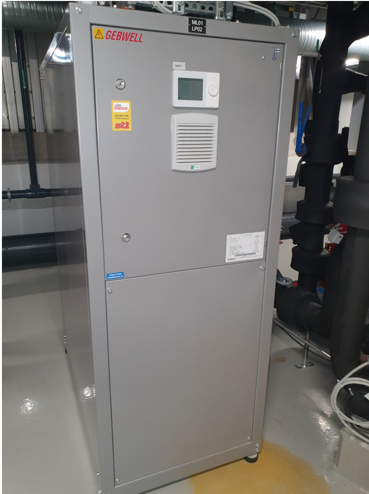
Kuva 8. Suuremman maalämpöpumpun sisäyksikkö. Kuva: Ramboll Finland Oy.
