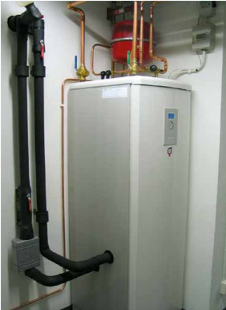
Kuva 7. Maalämpöpumpun sisäyksikkö ja varaaja. Kuva: Jouni Lehtonen, Ympäristöministeriö Energiakaivo 2013.
