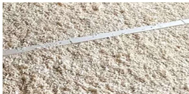
Ehta Talojen kutterinlastueristettä välipohjassa [1]
